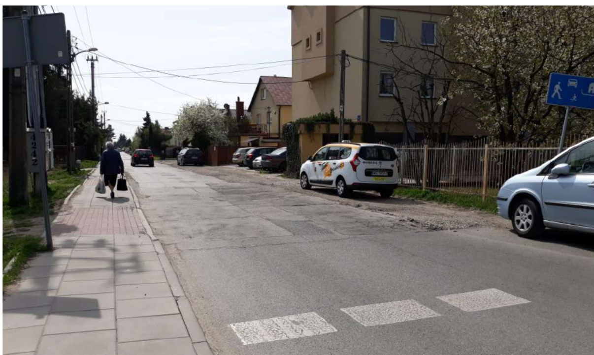
ZDJĘCIE 73 ZŁY STAN NAWIERZCHNI JEZDNI PRZED PRZEJŚCIEM
