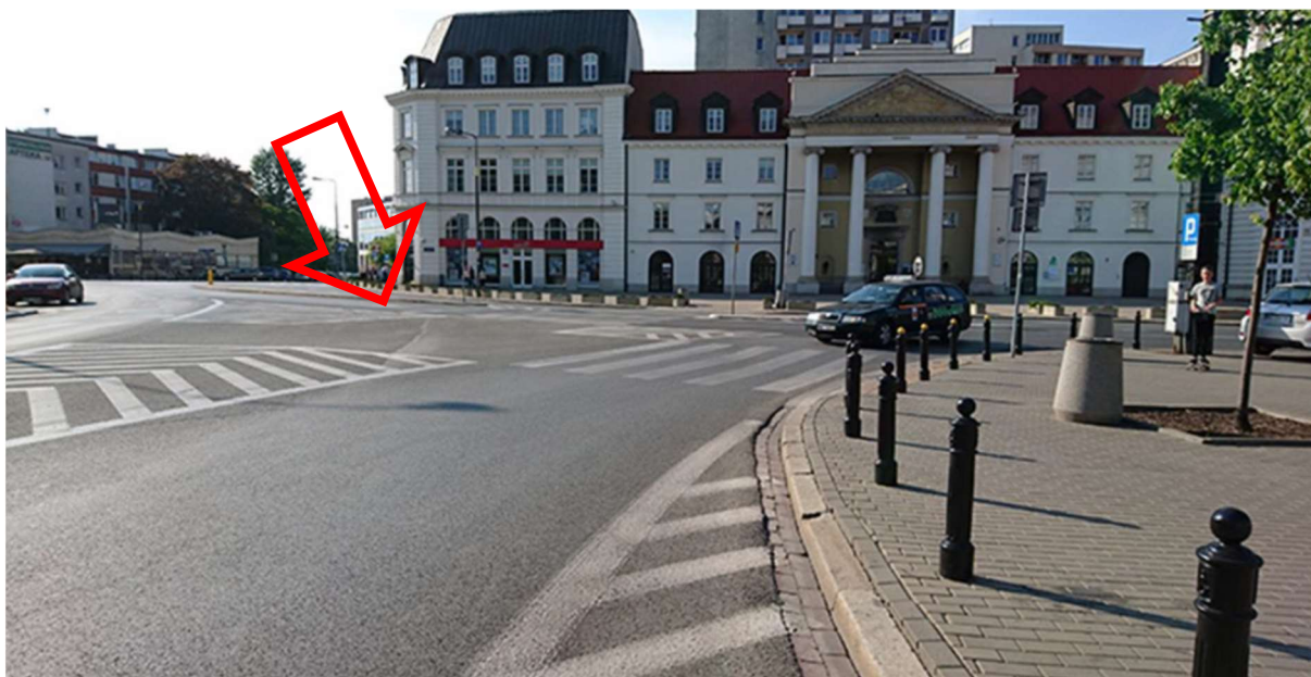
ZDJĘCIE 69 PRZEJŚCIA DLA PIESZYCH PROWADZONE Z TRZECH KIERUNKÓW Z WYSPĄ TRÓJKĄTNĄ OTOCZONĄ LINIĄ P-21, KTÓRA NIE ZABEZPIECZA PIESZEGO
