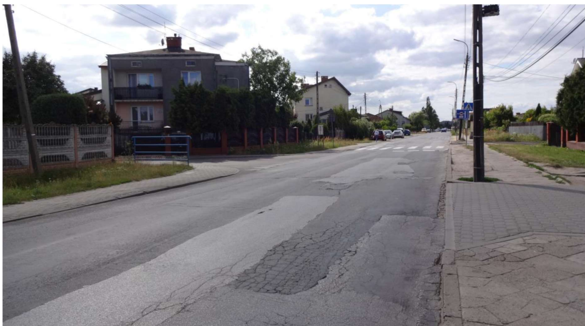
ZDJĘCIE 71 ZŁY STAN NAWIERZCHNI JEDNI PRZED PRZEJŚCIEM
