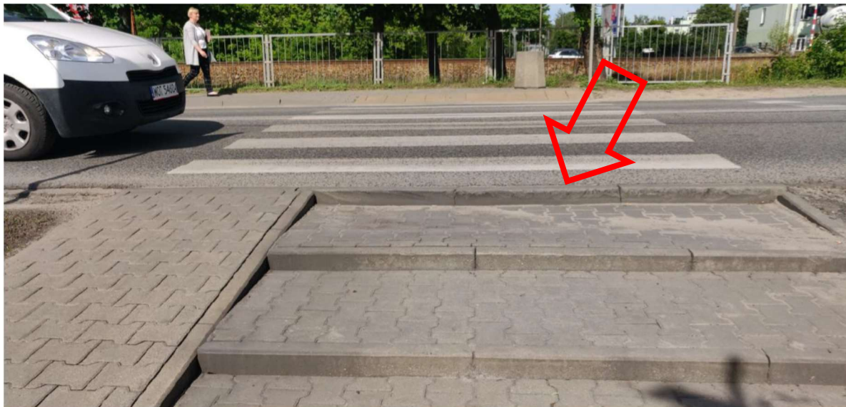
ZDJĘCIE 12 NIEPRAWIDŁOWO UKSZTAŁTOWANA KRAWĘDŹ JEZDNI W OBSZARZE PRZEJŚCIA
