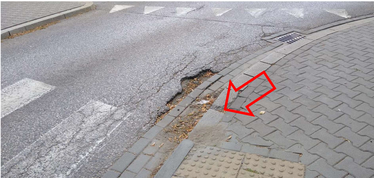
ZDJĘCIE 28 OBNIŻENIE NAWIERZCHNI JEZDNI I CHODNIKA W OBSZARZE PRZEJŚCIA DLA PIESZYCH. ŚLADY DEGRADACJI NAWIERZCHNI
