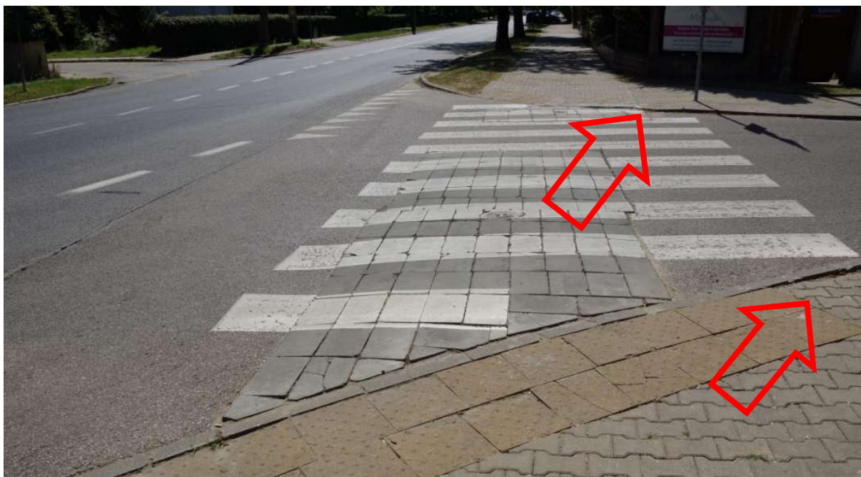
ZDJĘCIE 3 PŁYTKI OSTRZEGAWCZE DLA NIEWIDOMYCH ZASTOSOWANE NA NIEPEŁNEJ SZEROKOŚCI PRZEJŚCIA, W ZŁYM STANIE TECHNICZNYM
