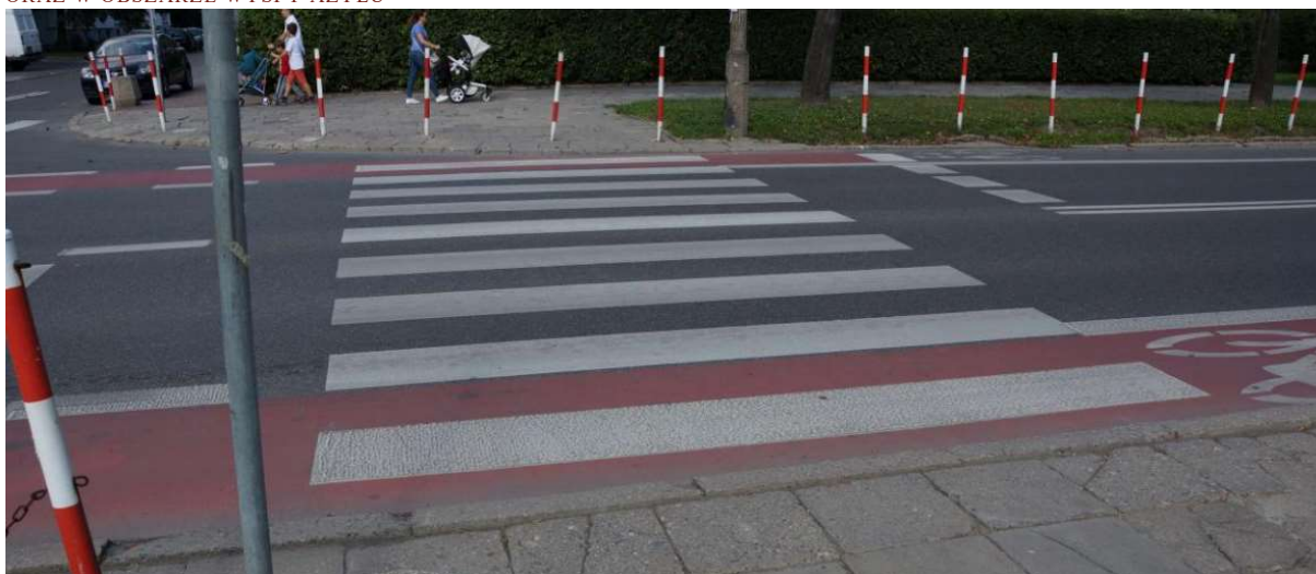
ZDJĘCIE 2 BRAK RAMPY I PŁYTEK OSTRZEGAWCZYCH DLA NIEWIDOMYCH I NIEDOWIDZĄCYCH NA KRAWĘDZI JEZDNI
