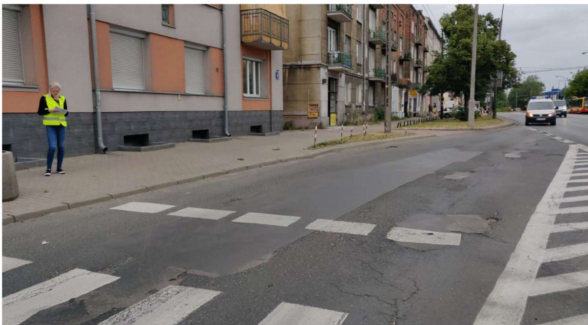
ZDJĘCIE 74 ZŁY STAN NAWIERZCHNI JEDNI PRZED PRZEJŚCIEM
