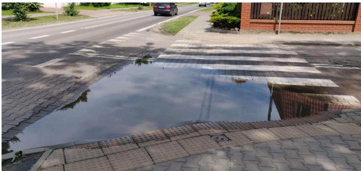
ZDJĘCIE 24 NAJNIŻSZY PUNKT ZLEWNI W OBSZARZE PRZEJŚCIA DLA PIESZYCH, WODA W OBNIŻENIU NAWIERZCHNI
