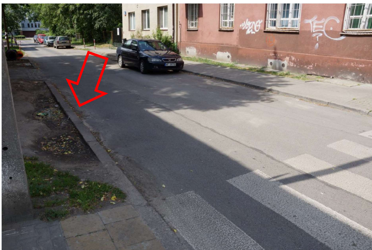
ZDJĘCIE 46 PRZEJŚCIE WRAŻLIWE NA ZASTAWIANIE I OGRANICZENIA WIDOCZNOŚCI. ŚLADY KÓŁ PARKUJĄCYCH POJAZDÓW PRZED PRZEJŚCIEM DLA PIESZYCH
