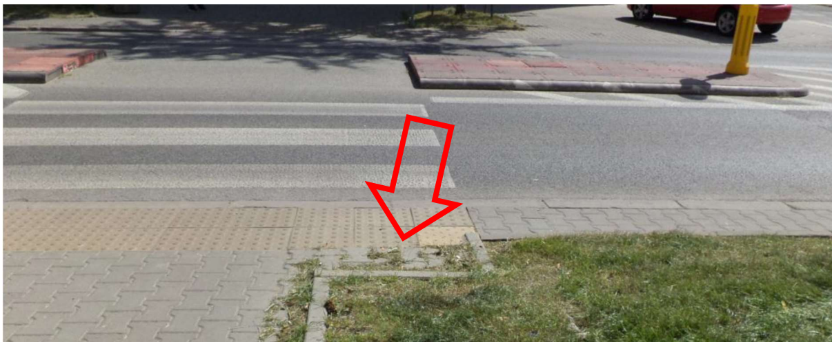
ZDJĘCIE 106 BRAK MIEJSCA NA OPUSZCZENIE PRZEJŚCIA DLA PIESZYCH
