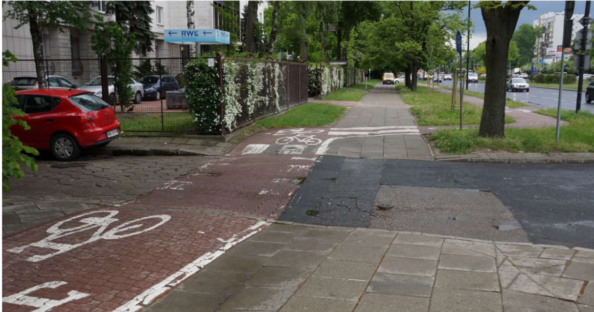
ZDJĘCIE 22 NIEPEŁNE OZNAKOWANIE POZIOME PRZY PEŁNYM OZNAKOWANIU PIONOWYM PRZEJŚCIA DLA PIESZYCH. NAWIERZCHNIA PRZEJŚCIA DLA PIESZYCH I OZNAKOWANIE POZIOME PRZEJAZDU DLA ROWERÓW W ZŁYM STANIE.
