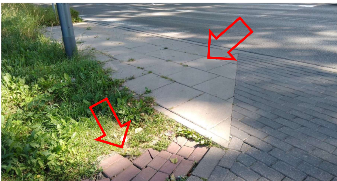
ZDJĘCIE 9 ŚLADY ROZJEŹDŻANIA STREFY OCZEKIWANIA I PRZEJŚCIA DLA PIESZYCH
