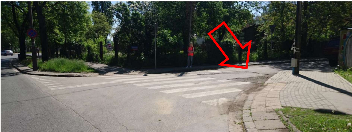
ZDJĘCIE 29 ŚLADY NIEPRAWIDŁOWO FUNKCJONUJĄCEGO ODWODNIENIA W OBSZARZE PRZEJŚCIA
