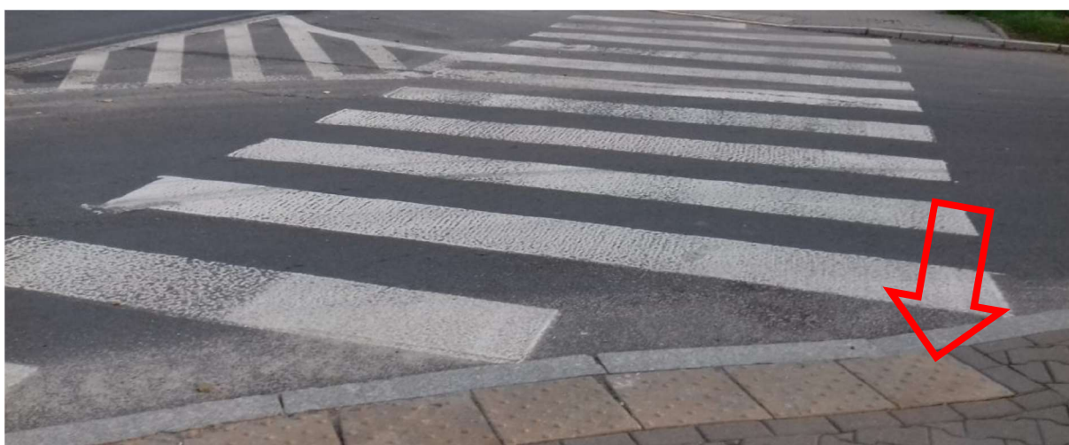
ZDJĘCIE 26 OBNIŻENIE NAWIERZCHNI JEZDNI I CHODNIKA W OBSZARZE PRZEJŚCIA DLA PIESZYCH I ŚLADY PO GROMADZĄCEJ SIĘ WODZIE
