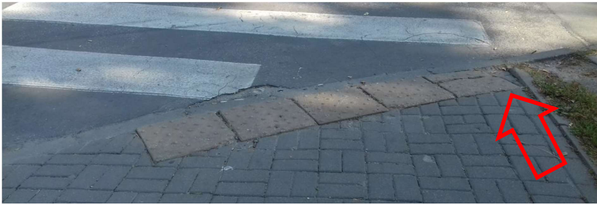
ZDJĘCIE 27 OBNIŻENIE NAWIERZCHNI JEZDNI I CHODNIKA W OBSZARZE PRZEJŚCIA DLA PIESZYCH
