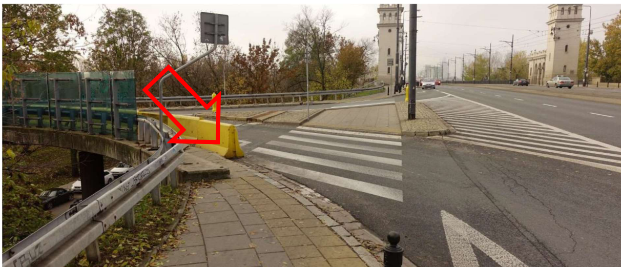
ZDJĘCIE 101 BARIERA BETONOWA I ELEMENT KONSTRUKCYJNY OBIEKTU INŻYNIERSKIEGO ZNAJDUJĄCE SIĘ NA DRODZE PIESZEGO
