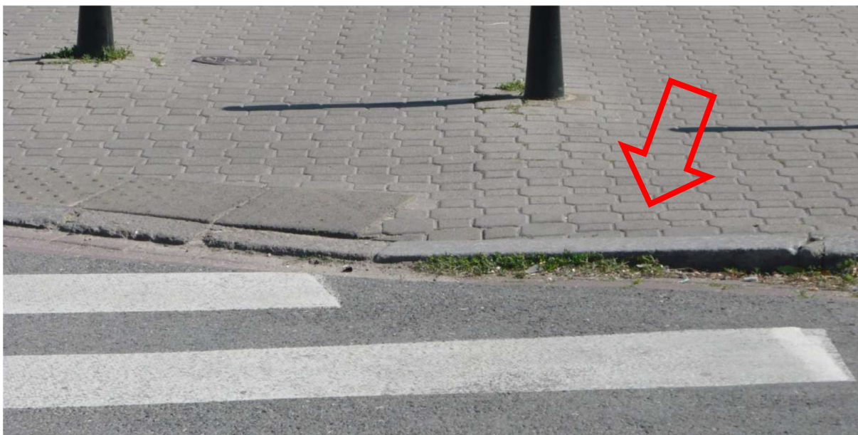
ZDJĘCIE 75 SKOS KRAWĘŻNIKA NA DŁUGOŚCI PRZEJŚCIA DLA PIESZYCH BĘDĄCY PRZESZKODĄ DLA PIESZEGO
