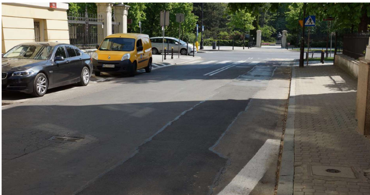
ZDJĘCIE 72 ZŁY STAN NAWIERZCHNI JEZDNI PRZED PRZEJŚCIEM
